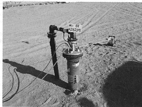
Fig. 11d Puits injecteur du pilote ISR de SUD TORTKUDUK sur le gisement 17y (KATCO, Kazakhstan ; © R. Mathieu, Orano).
