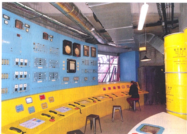
Photo 10. Salle de commande de l'usine. Crédit-Photo : Pierre-Christian Guiollard.
